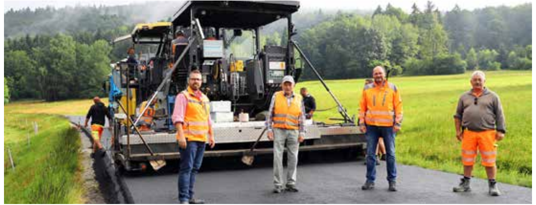
Zufrieden mit dem Baufortschritt bei den Asphaltierungsarbeiten auf der St 2134 bei Ölberg sind Martin Ebner (v.l.), der zuständige Sachgebietsleiter am Staatlichen Bauamt Passau, Hubert Franz vom Ingenieurbüro Klein, Bauleiter Claus Moser und Kapo Alfred Helmbrecht, beide Firma Donauasphalt.
