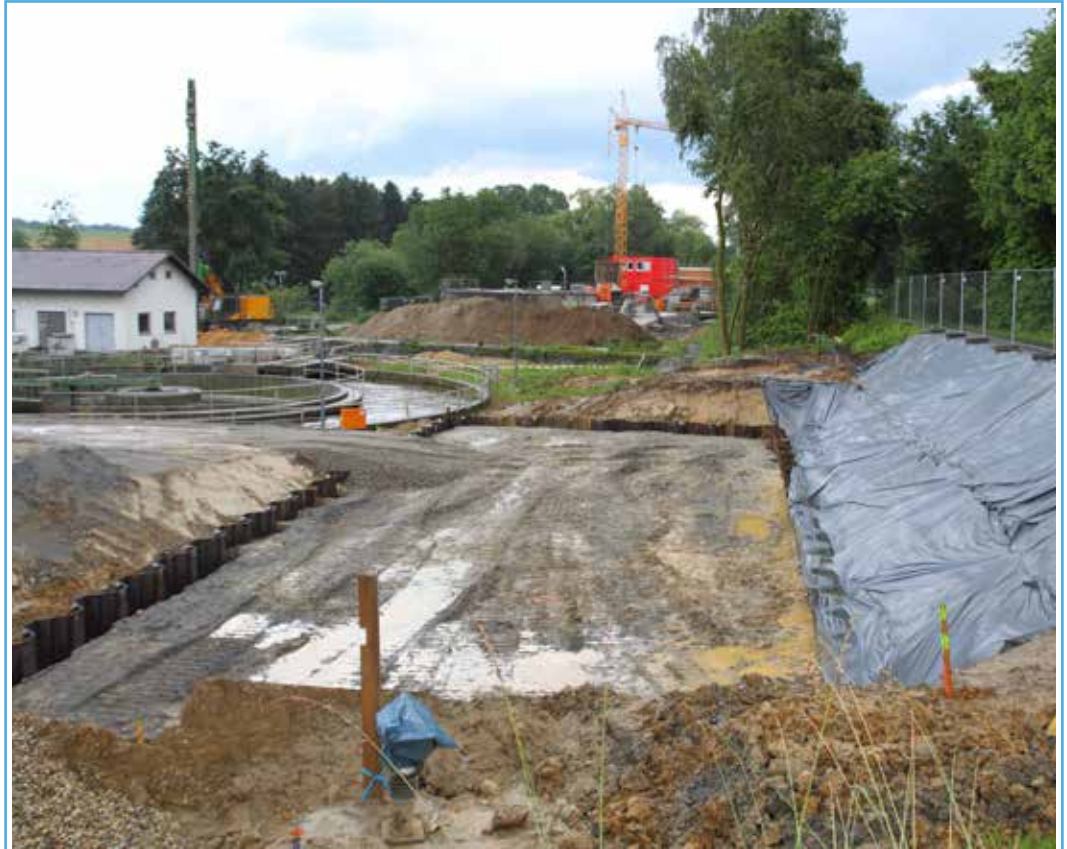
An der Schöllnacher Kläranlage wird aktuell der Erdaushub ausgeführt. Außerdem werden die Spundwände für das neue Rechengebäude errichtet.
